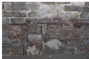
Pilzbefall Balken „Jupihaus“
