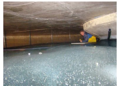
Eisspeicher im Betrieb, Fa. Isocal
