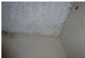
Feuchteschaden Wohnung „Jupihaus“
