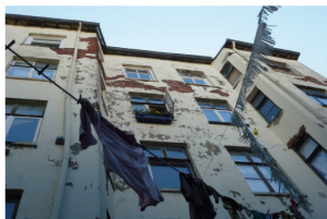
Abblätternder Putz Rückseite „Kupferdiebehaus“
