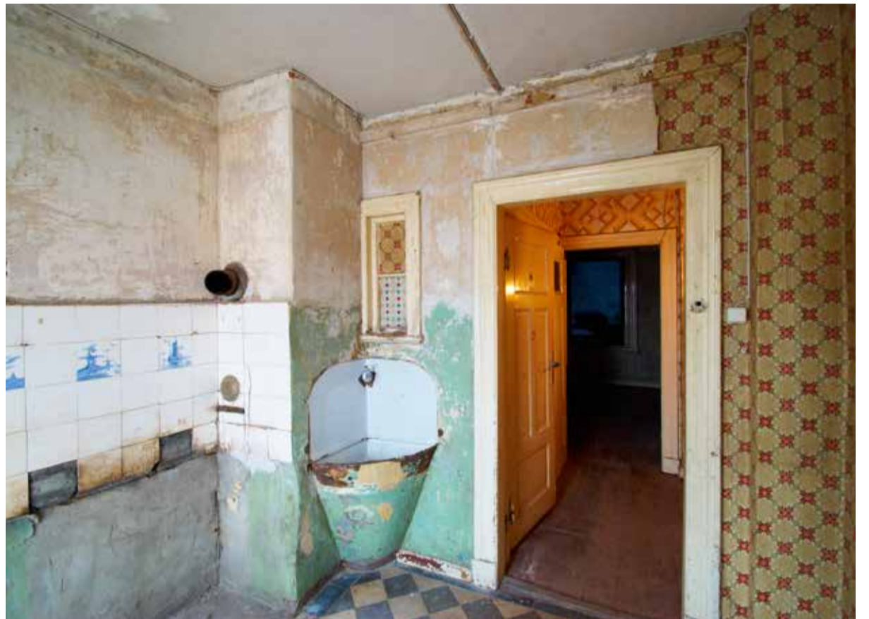
Von den Folgen der Sanierung bedroht ist auch dieser Innenraum im Kutscherhaus – Foto: Franziska Holz, 2011
